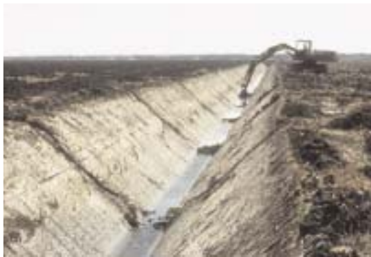
L'eau en excès dans les drains est récupérée par un collecteur.
